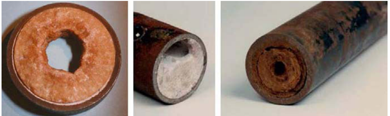
Рис. 7. Отложения накипи на стенках труб.
