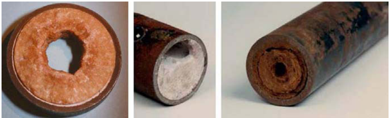
Рис. 7. Отложения накипи на стенках труб.
