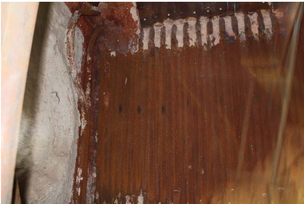
Рис.5-6 Изношенные поверхности котлоагрегатов
