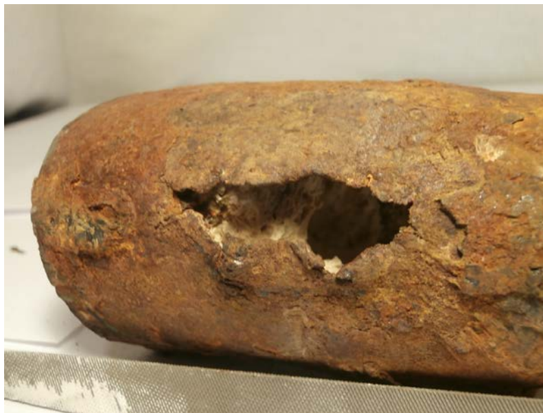
Рис. 8. Разрыв стенки трубы вследствие отложения накипи.
